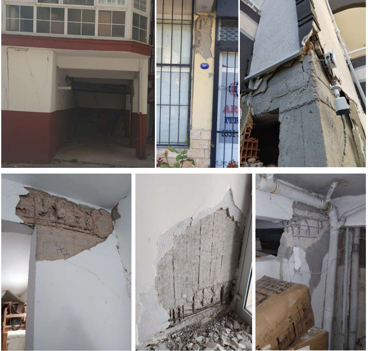
Şekil 6.12 Lokal ağır yapısal hasarlar
