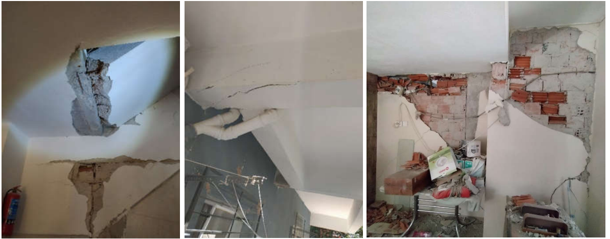
Şekil 6.8 Adalet Sitesi'nde gözlenen hasar
