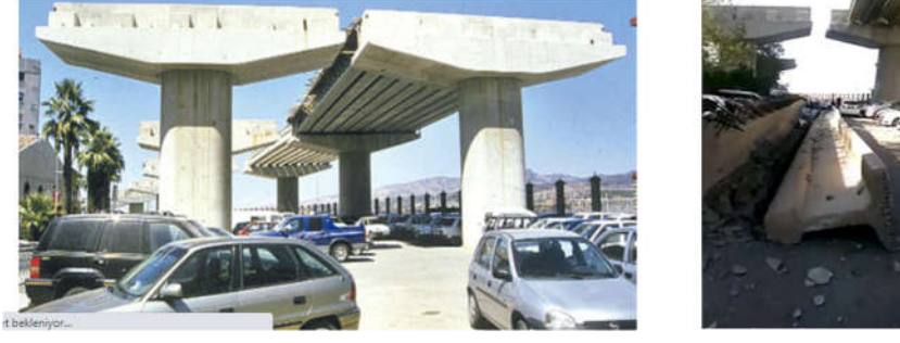
Şekil 6.18 Yapımı 20 sene önce durmuş ve yanal stabilitesi olmayan kirişler
