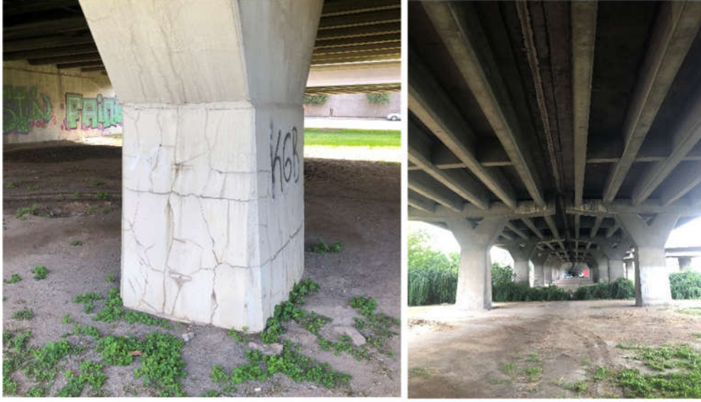
Şekil 6.16 Kimyasal Tepkime Sonucu ASR Kaynaklı Çatlaklar ve Genel Görünüm
