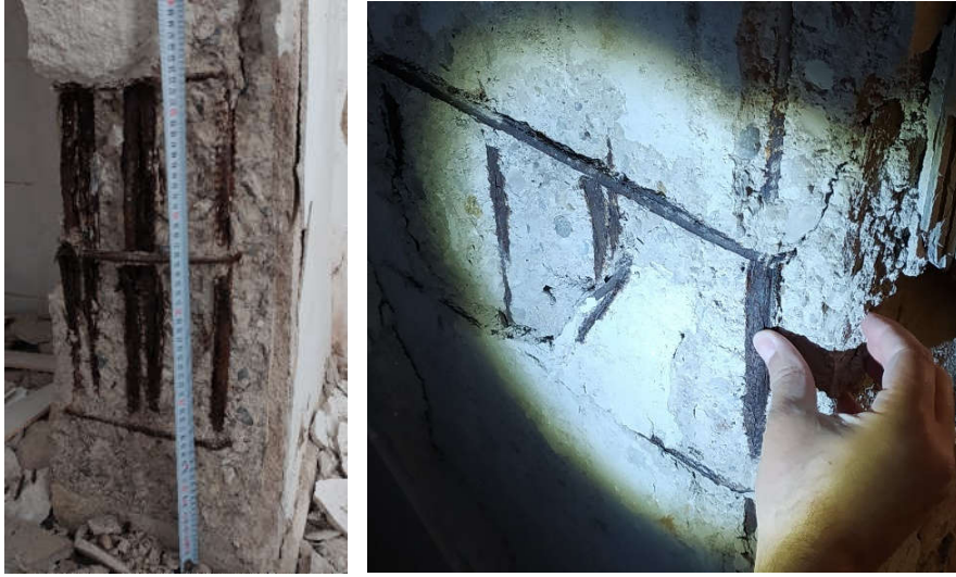
Şekil 6.10 Aşırı korozyona maruz kolon donatıları
