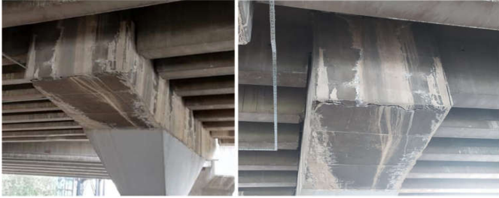
Şekil 6.17 Deprem Öncesi ASR Çatlağı Olan Köprü Ayağından Görüntü (Aralık, 2019) ve (Kasım 2020)
