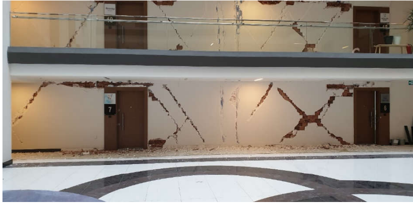
Şekil 6.11 İş merkezi hasarı
