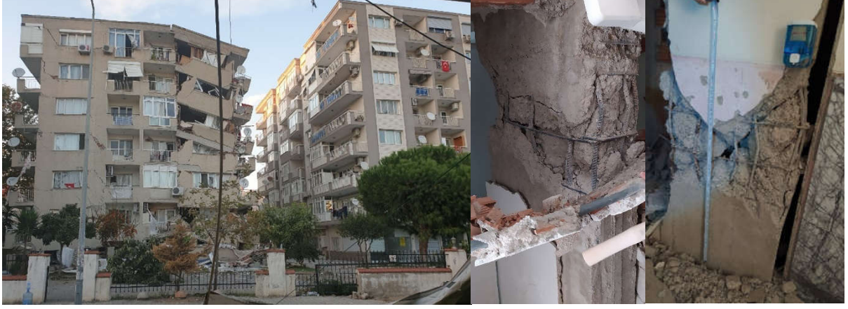
Şekil 6.9 Egemen sitesi, göçen ve hasarsız gibi duran binalar
